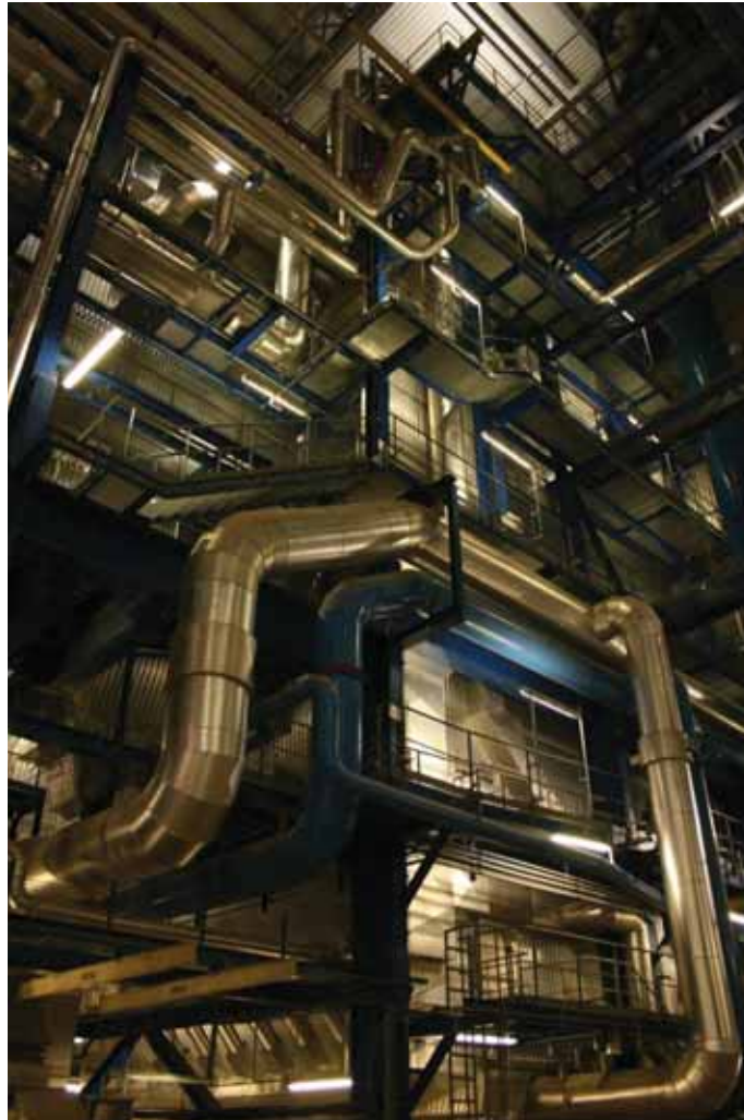
Figure 13: Groupe Four Chaudière (GFC)
