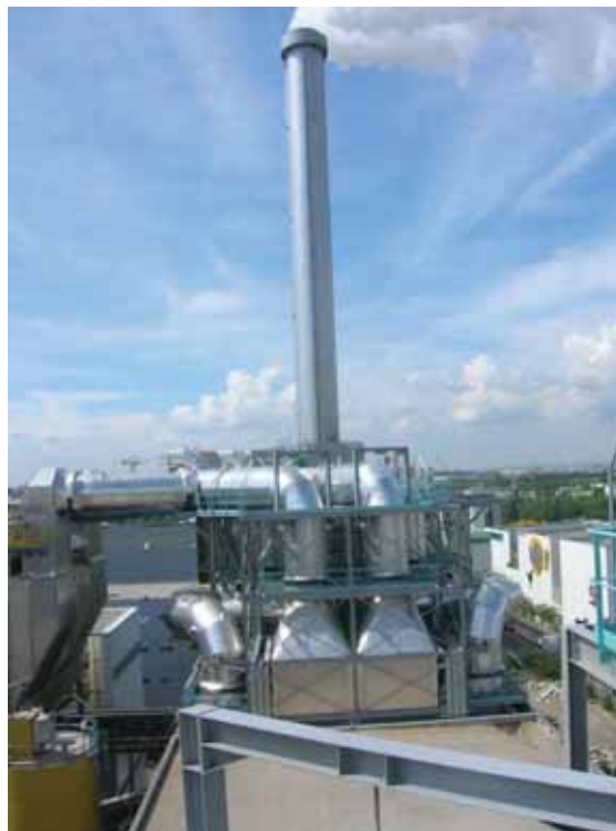
Figure 1 - vue d'une ligne de traitement des fumées
