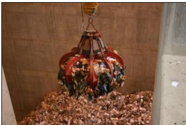
Figure 10 : Grappin sur pont-roulant en fosse
