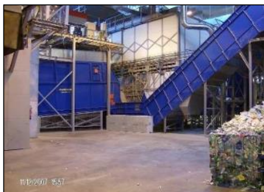
Figure 8 : Photo de la zone de conditionnement de mise en balles de la collecte sélective
