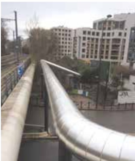
Raccordement du réseau de collecte pneumatique au centre Isséane
