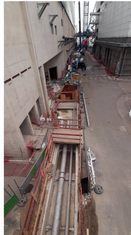
Caniveau vapeur connecté au réseau CPCU.
