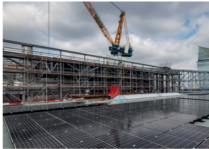
Panneaux photovoltaïques en toiture.
